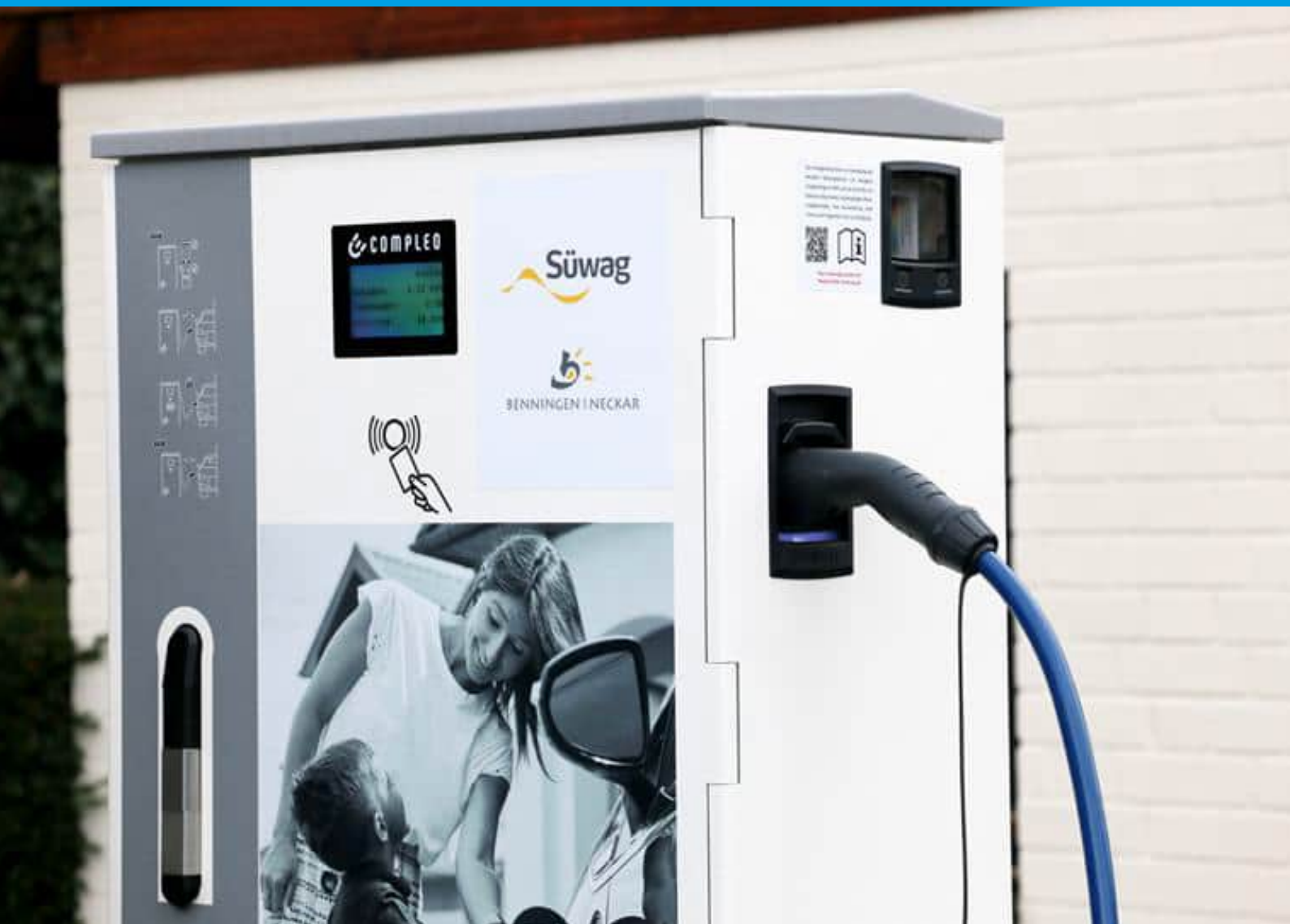
Bildquelle: Gemeinde Benningen a. N.; Ladestation in der Kastellstraße
